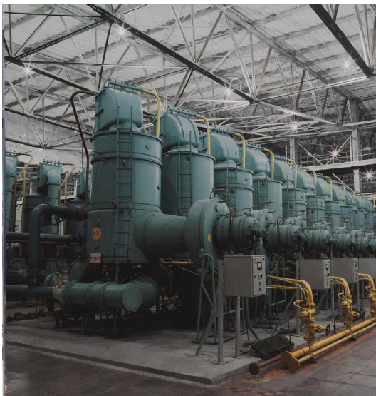
Рис.4.2. Блок газодиффузионных машин на Уральском электрохимическом комбинате (УЭХК)
